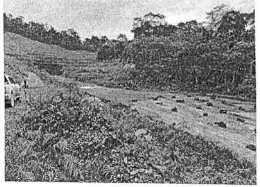
Foto N°1. Descarga final de aguas del túnel de decantación hacia fuera del área de influencia del proyecto.
